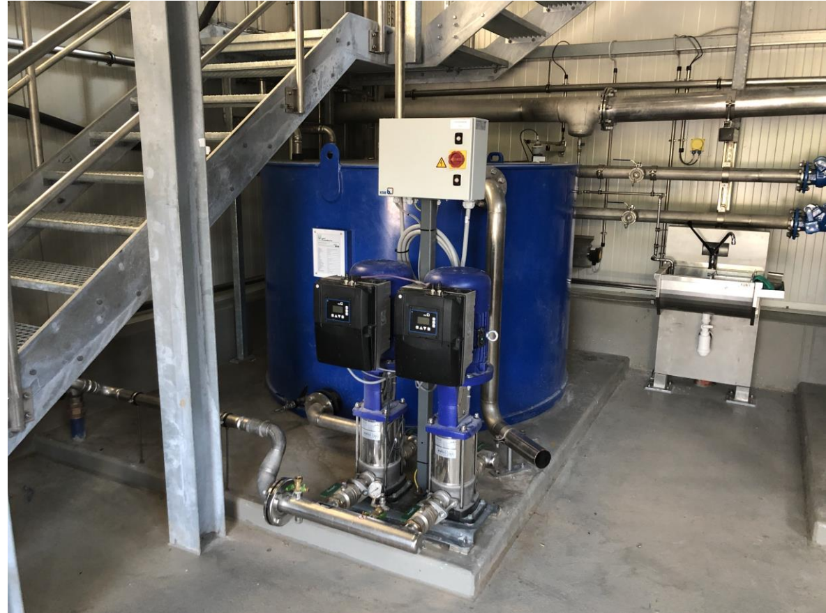
Druckerhöhungsanlage mit Brauchwasserbehälter (3,6 m 3 )
