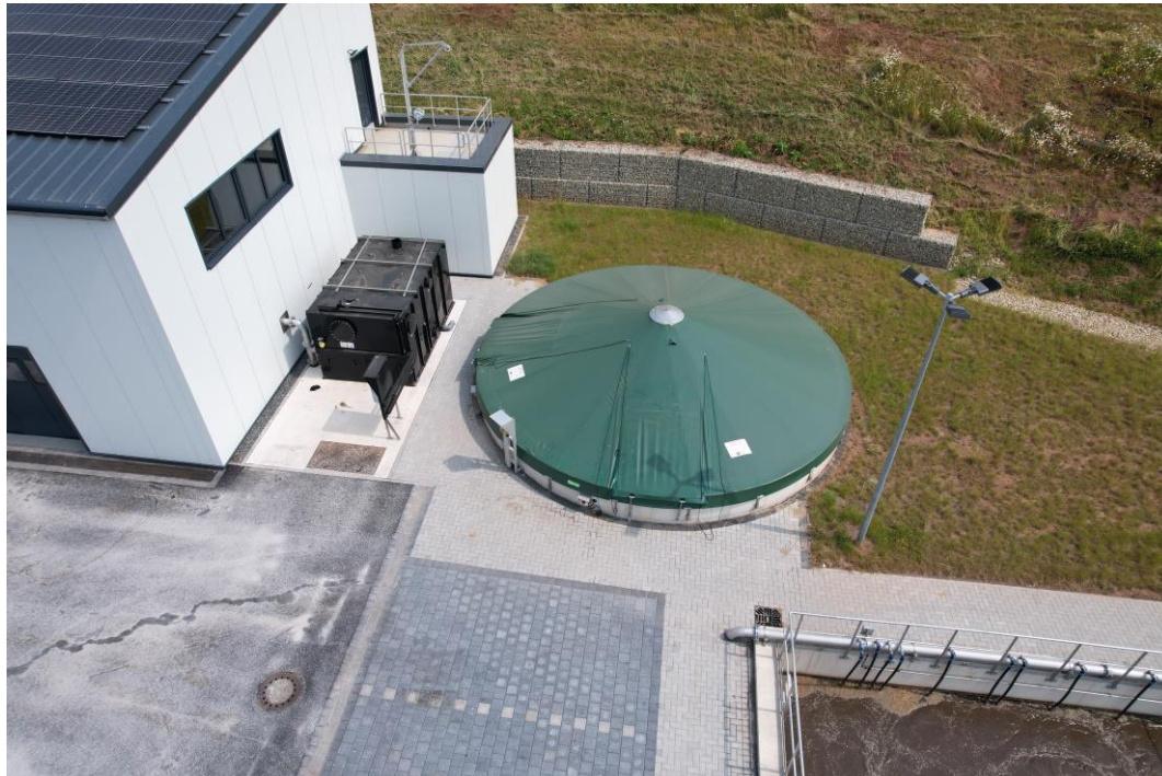
Trübwasser- und Zentratspeicher
