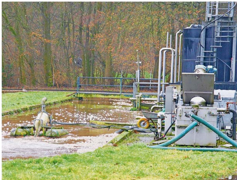
Die bisherige Kläranlage in Mettendorf hat weitgehend ausgedient und wird durch eine neue ersetzt.
