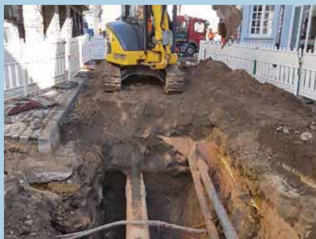
Versorgungsleitungen im Baustellenabschnitt
